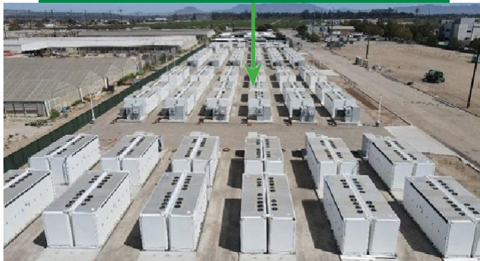
Unidades nuevas instaladas en exteriores
