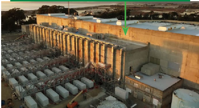
Unidades antiguas instaladas dentro de edificios
